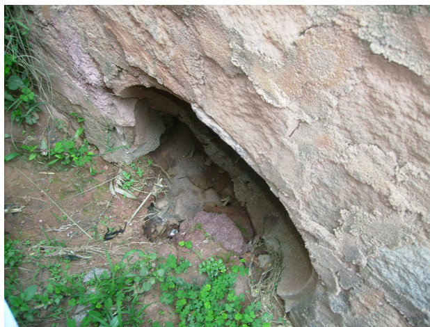
PHOTOS 52- Buse endommagée au PK 1+820
