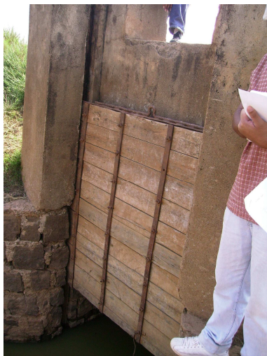
PHOTOS 50- Vanne usée
