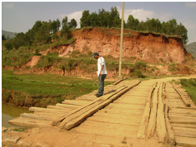
PHOTOS 55- Dégradation du tablier
