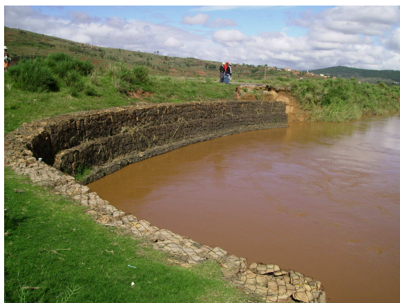
PHOTOS 53- Gabions au PK 0+556
