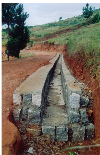
PHOTOS 66- Fossé droite
