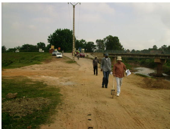
PHOTOS 43- Dégradation généralisée
