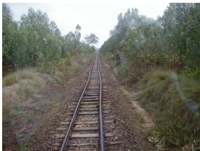
Photo 3: Déversement de la file de rails
