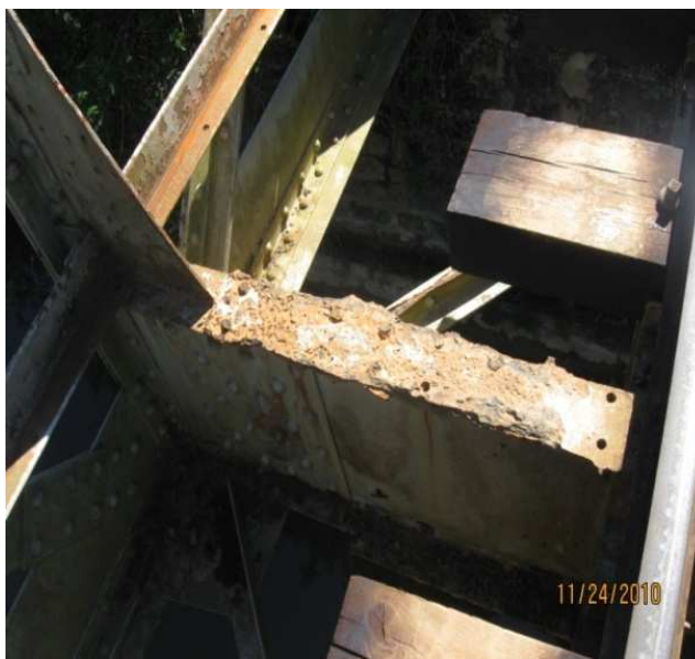
Photo 6: Corrosion au niveau du longeron
