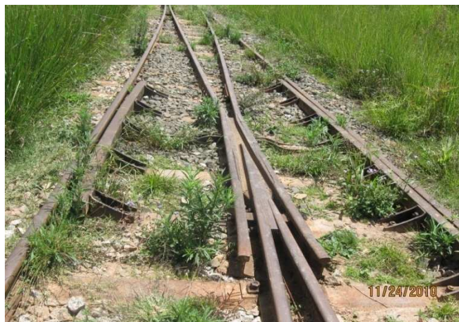
Photo 2: Dégradation de la couche de Ballast
