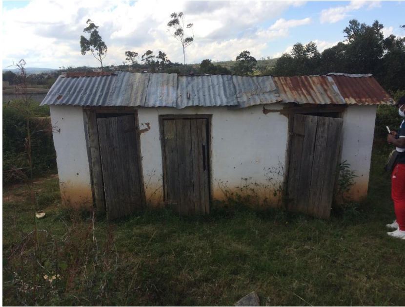
Photo 7 : Latrine dans l'EPP Ambodivona
